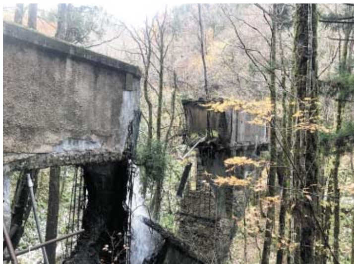
滑落している導水橋(旧大錠集落の上流部)
