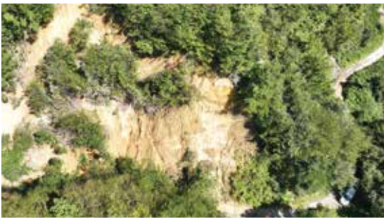
法面崩落と路肩決壊(林道春沢線)
